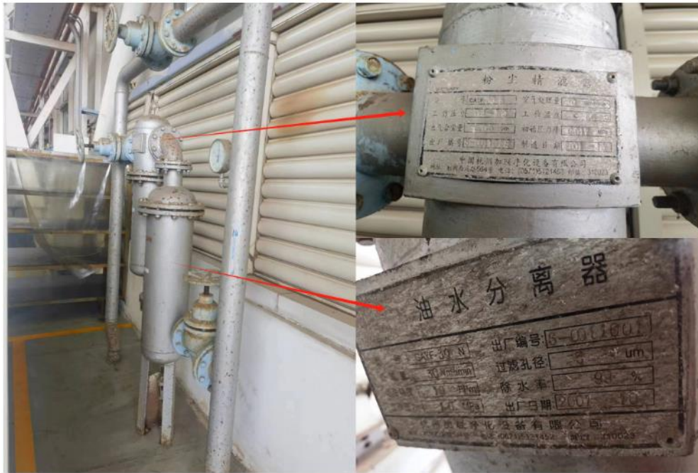
原使用端（机库）安装的过滤器
